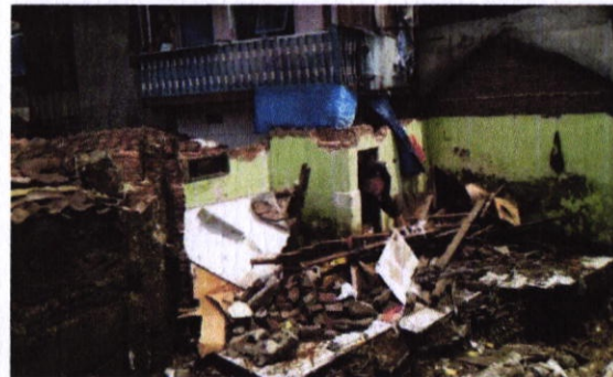
Gambar 2.17 Puing Akibat Banjir di Pagarsih, Kota Bandung 2017
